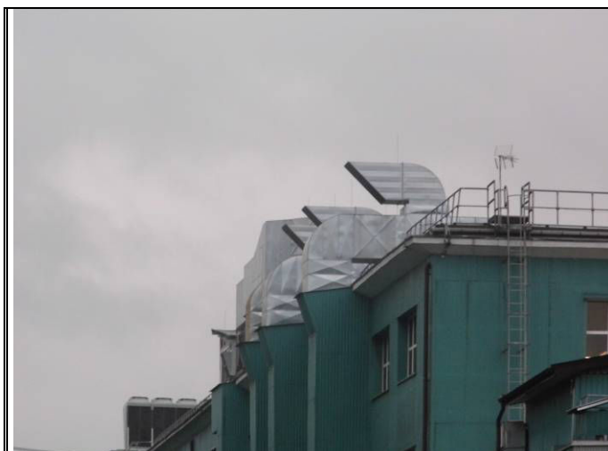
FOT 9. Obszar planu – emitory na dachu zakładu
