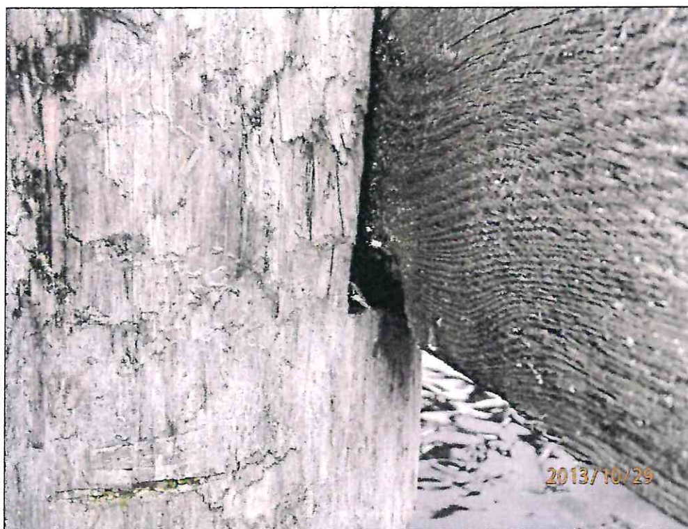
Fot.14 Uszkodzenia korozyjne pala
