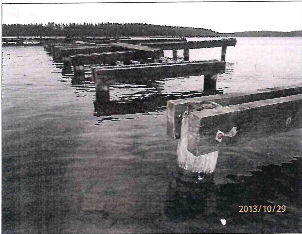
Fot 9 Uszkodzenia głowicy pala
