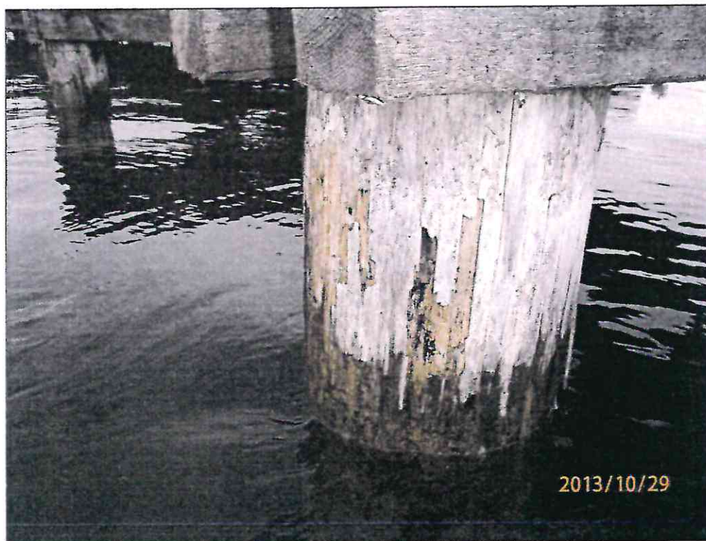
Fot.6 Uszkodzenia pala
