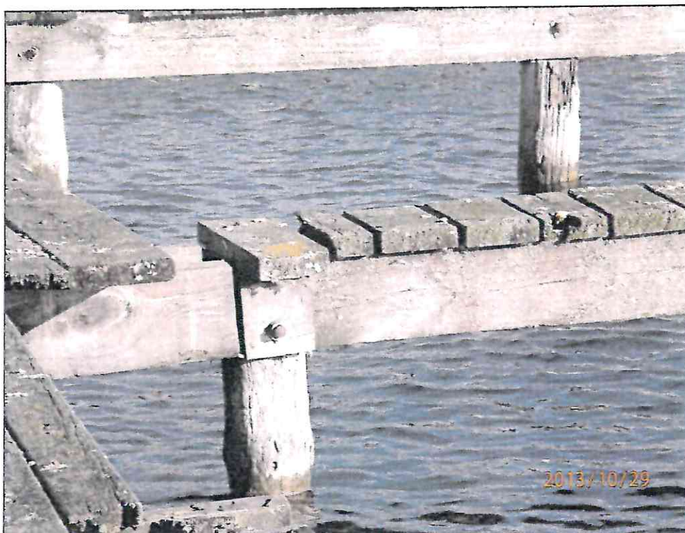
Fot.13 Uszkodzenia pomostu i pali
