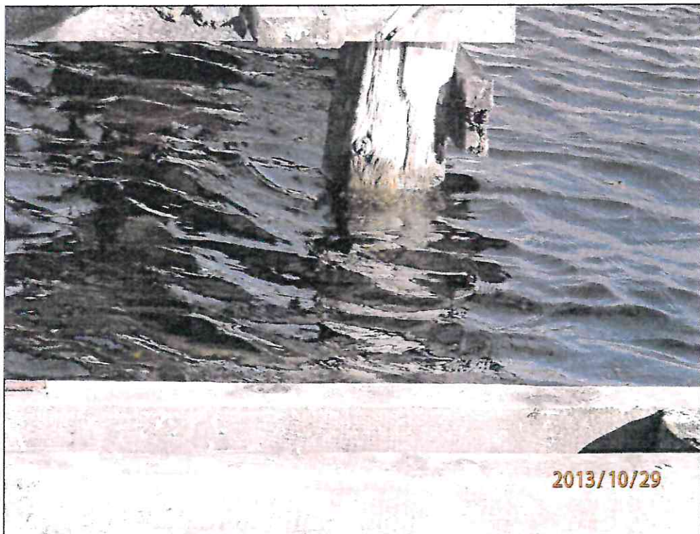
Fot.2 Uszkodzenia korozyjne: pala kleszcza i pomostu
