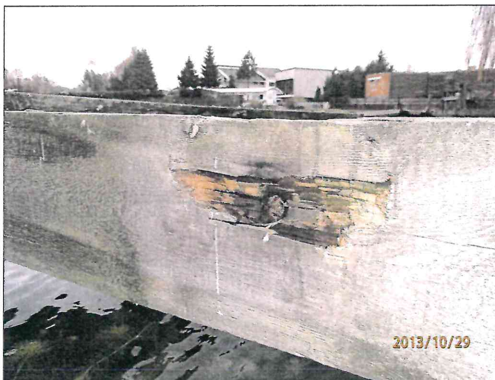
Fot.4 Uszkodzenie kleszczy
