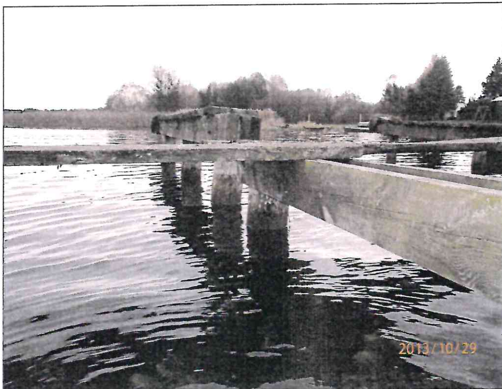
Fot.7 Uszkodzenia stanowisk korozyjnych
