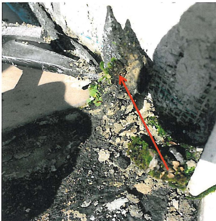
Fot. 28. Wadliwa izolacja połączenia posadzki z murkiem – widoczny luźny pasek papy, który z łatwością wysunął się z miejsca styku powierzchni tarasu ze ścianką
