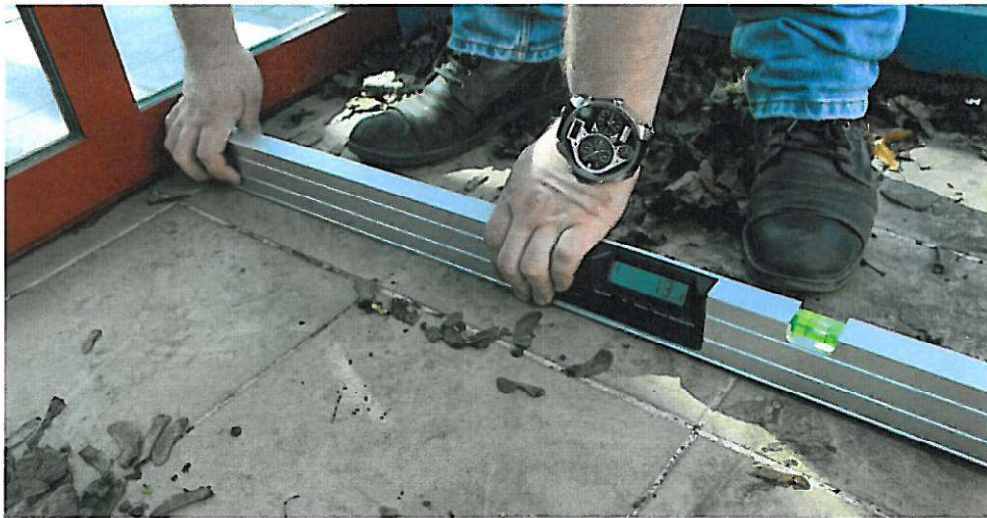
Fot. 21. Źle skonstruowany spadek (1,3% w kierunku drzwi na klatkę schodową)
