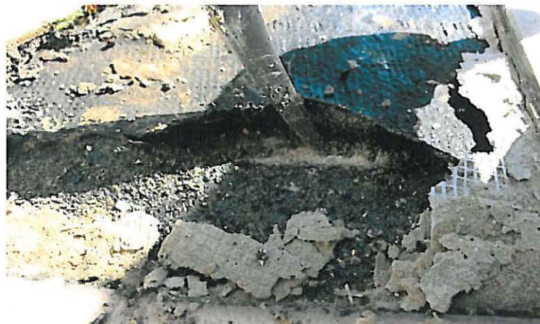
Fot. 26. Wadliwe wykonanie izolacji poziomej tarasu – papa łączona bez zakładu jest nieszczelna i nie przylega do podłoża
