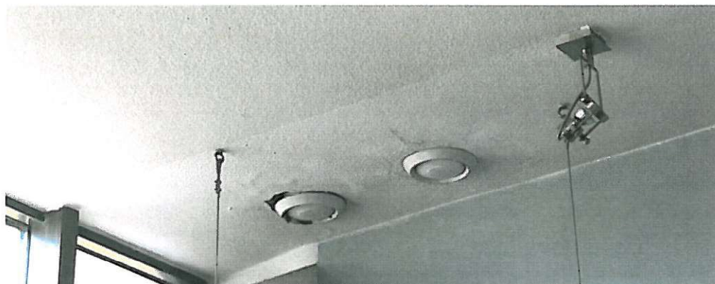
Fot. 24. Zawilgocenie stropu parteru w pobliżu kanałów wentylacyjnych
