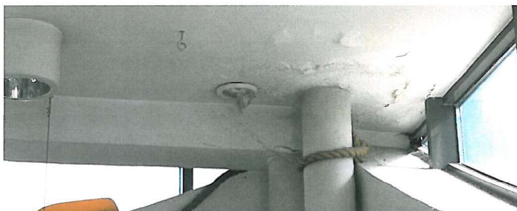
Fot. 25. Kumulacja wilgoci w stropie parteru w okolicy kanału wentylacyjnego i słupa, w którym znajduje się nieszczelny drenaż wód opadowych
