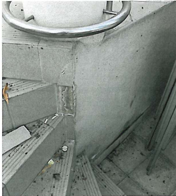
Fot. 18. Zacieki z wód opadowych spływających z tarasu do wnętrza klatki schodowej
