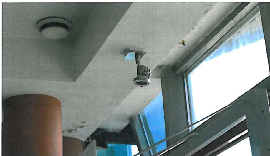
Fot. 19a. Zawilgocenie stropu piętra – widoczne zacieki z soli na stolarce okiennej
