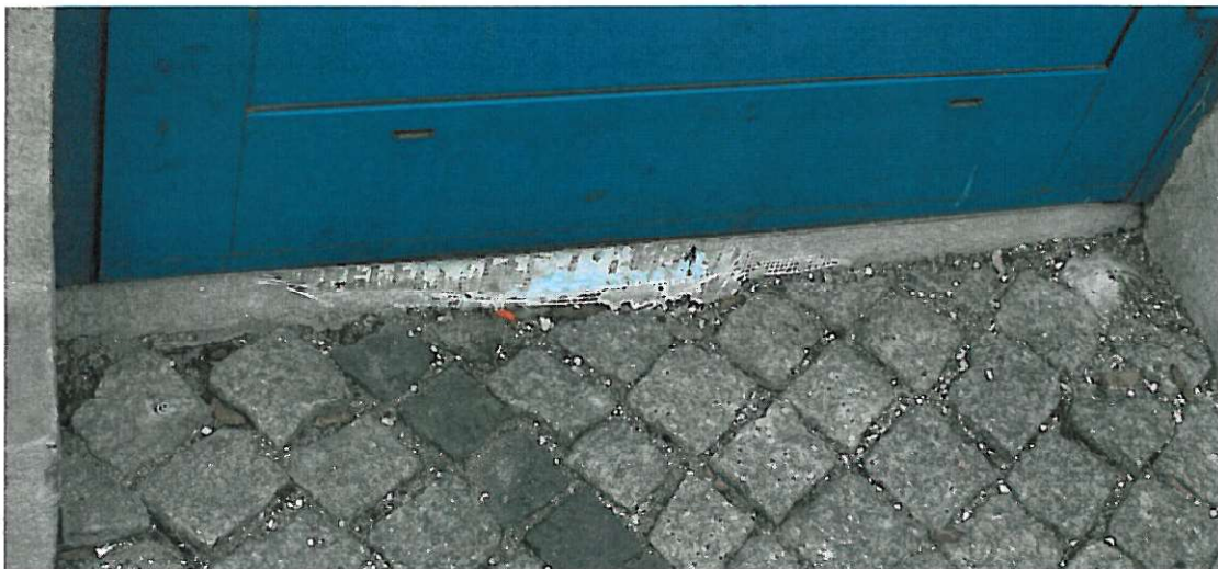
Fot. 8. Uszkodzenie elewacji poniżej drzwi zewnętrznych
