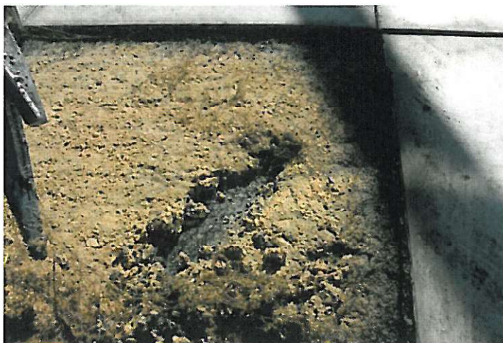
Fot. 27. Zaprawa klejowa utraciła swoje właściwości i akumuluje wodę opadową
