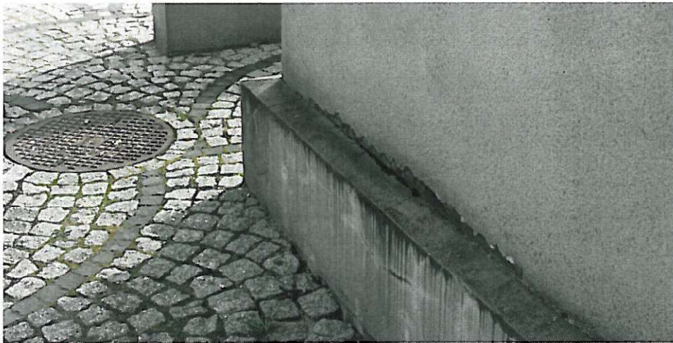
Fot. 9. Widoczny wpływ opadów atmosferycznych na cokół budynku
