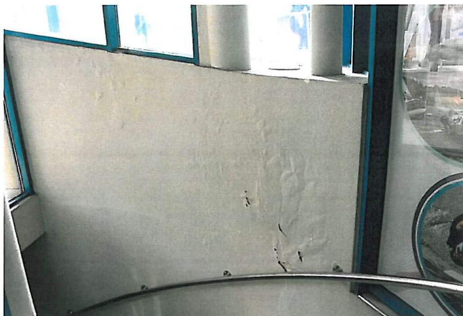
Fot. 2. Zawilgocenie ściany zewnętrznej przy zejściu do piwnic
