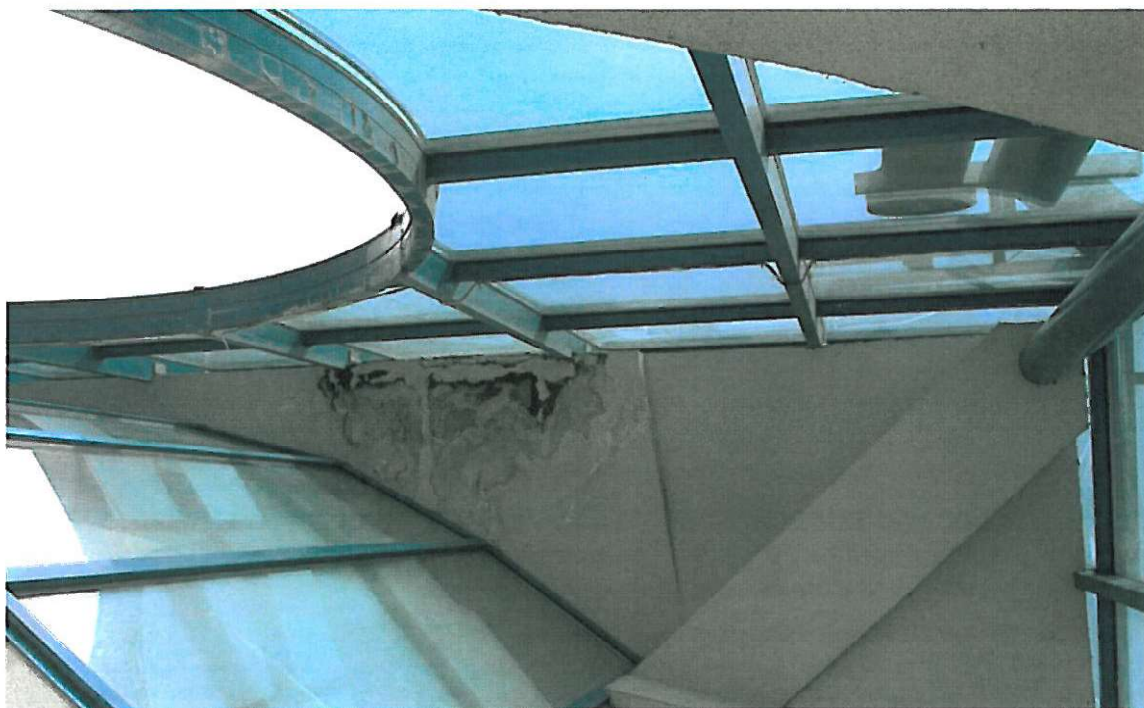
Fot. 17. Zawilgocenie spocznika schodów na skutek zalewania klatki schodowej i nieszczelnego połączenia stolarki okiennej z izolacją poziomą tarasu
