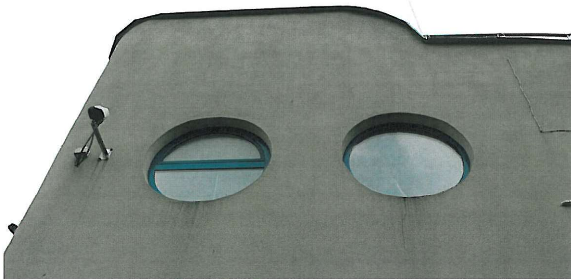
Fot. 30. Zarysowania tynku przy otworach okiennych
