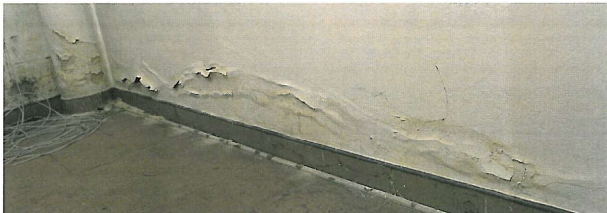
Fot. 12. Podciąganie kapilarne wody w ścianie kotłowni
