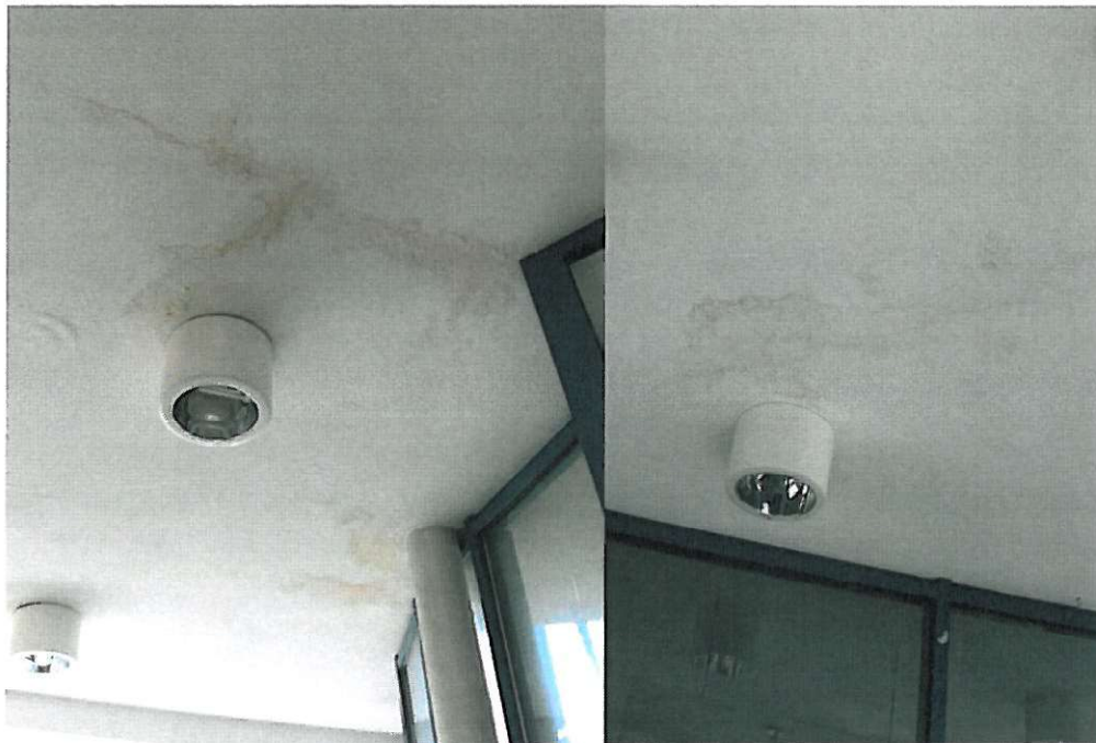
Fot. 23. Zawilgocenia stropu parteru od nieszczelności bruzd i przebić inst. elektrycznej
