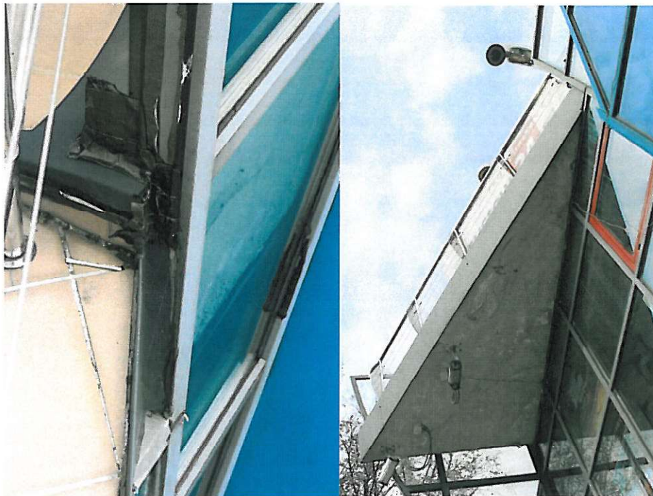
Fot. 22. Nieszczelne obróbki blacharskie i uszczelnienia styku ze stolarką ( z lewej) oraz zawilgocenie spodu tarasu (z prawej)
