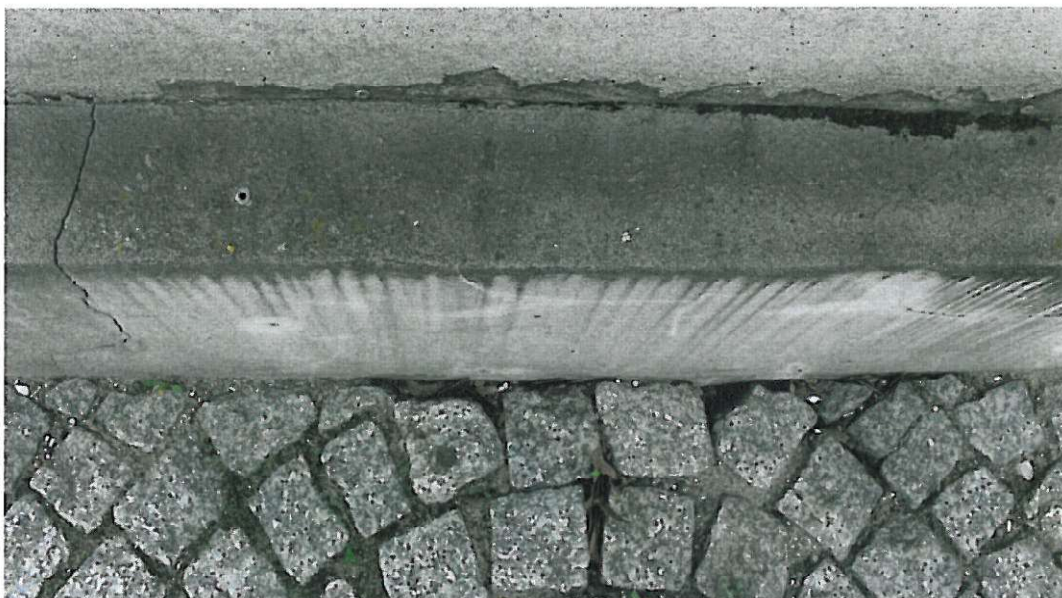
Fot. 10. Miejsce przesiąkania wód opadowych przy ścianie pomieszczenia kotłowni
