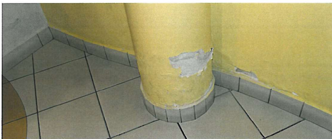
Fot. 13. Zawilgocenie ściany podziemia
