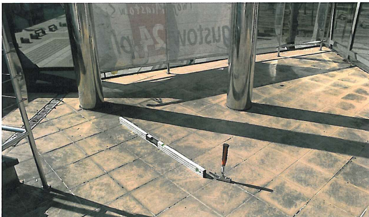
Fot. 20. Miejsca zbierania się zanieczyszczeń pokazują, gdzie zbierają się wody opadowe – w pobliżu kanałów wentylacyjnych
