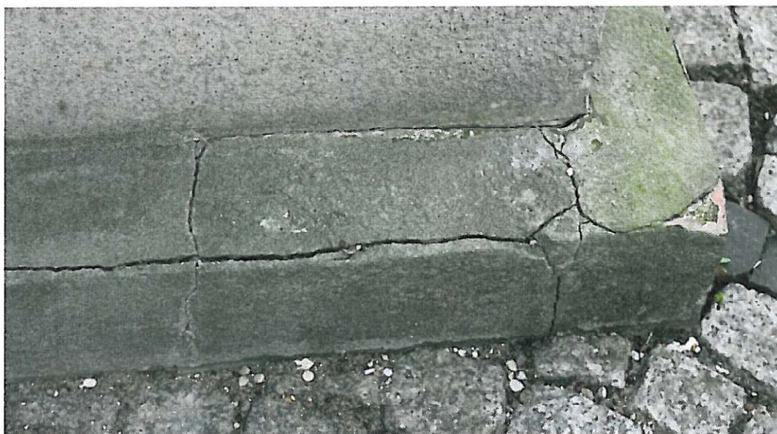
Fot. 6. Spękania i nieszczelności styku ścian fundamentowych i parteru
