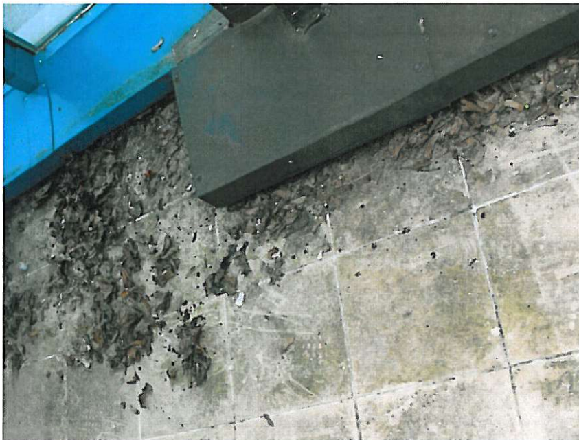
Fot. 19. Miejsce nieszczelnego połączenia stolarki okiennej ze stropem, powodujące przeciekanie wody na piętro i parter – Fot. 19a i 19b
