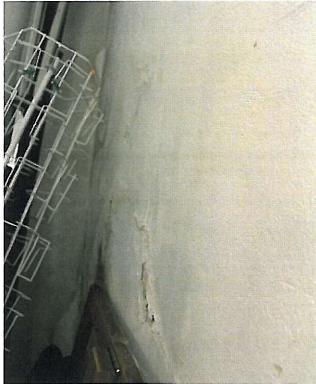
Fot. 1. Zawilgocenie ściany w narożniku do 2/3 jej wysokości
