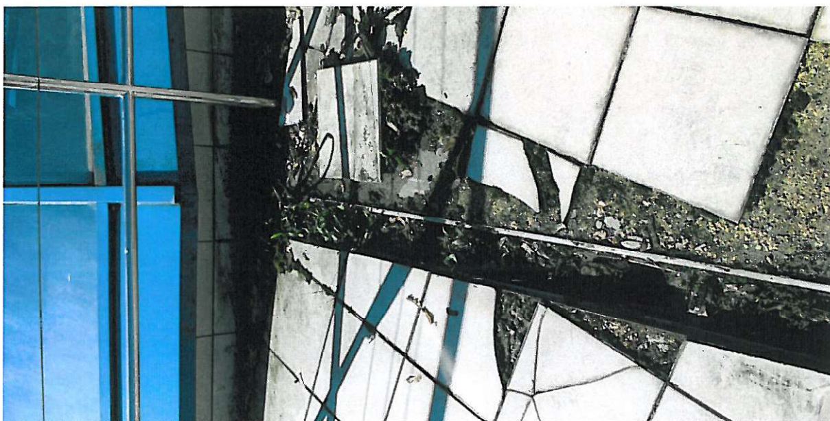
Fot. 29. Brak właściwego utrzymania korytek odwadniających i systemu drenażu wód opadowych z dachu
