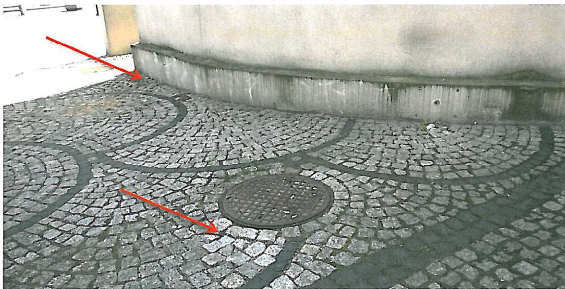
Fot. 5. Strzałki wskazują wgłębienia nawierzchni z bruku spowodowane wymywaniem piasku pod kostkami przez infiltrującą deszczówkę
