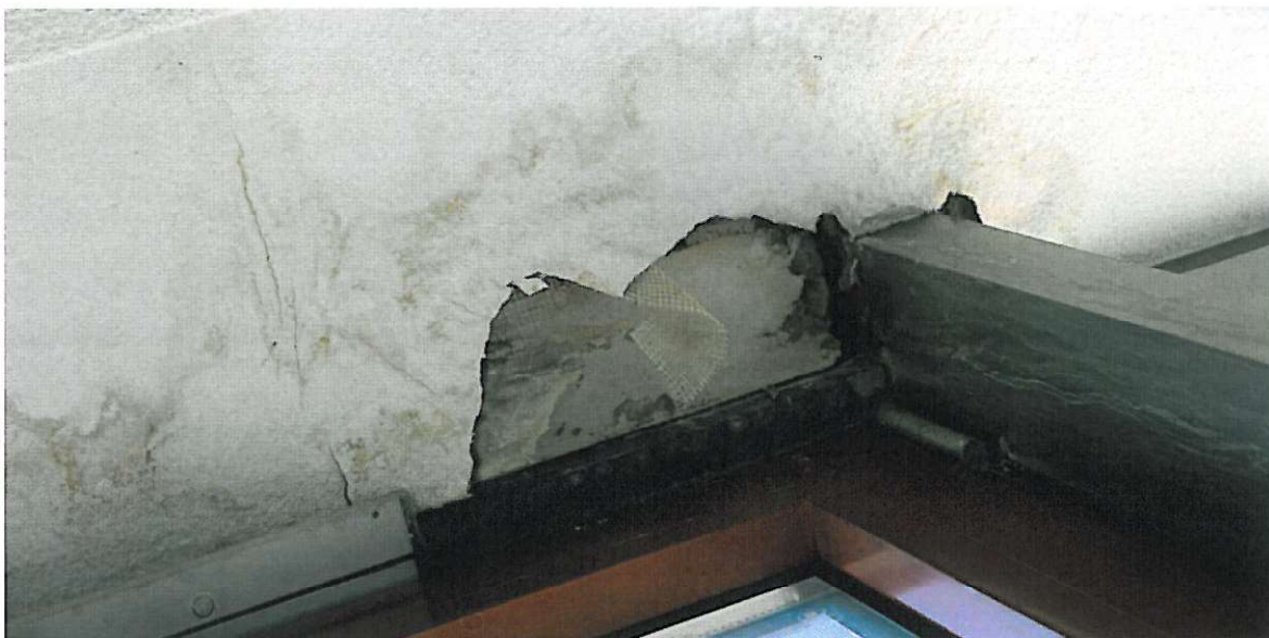
Fot. 19b. Zawilgocenie stropu parteru i zacieki na stolarnie okiennej
