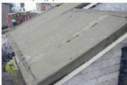
Azbestowa piślń dachowa
