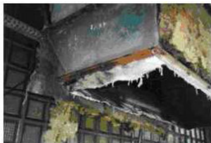
Płótno azbestowe w przewodach wentylacyjnych
