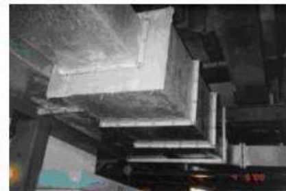
Uszczelnienie na złączach tłumików drgań w przewodach klimatyzacyjnych
